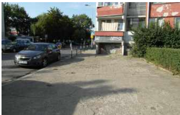
Rys. 103. Nierówna nawierzchnia ciągu pieszego (zdj. autor)
